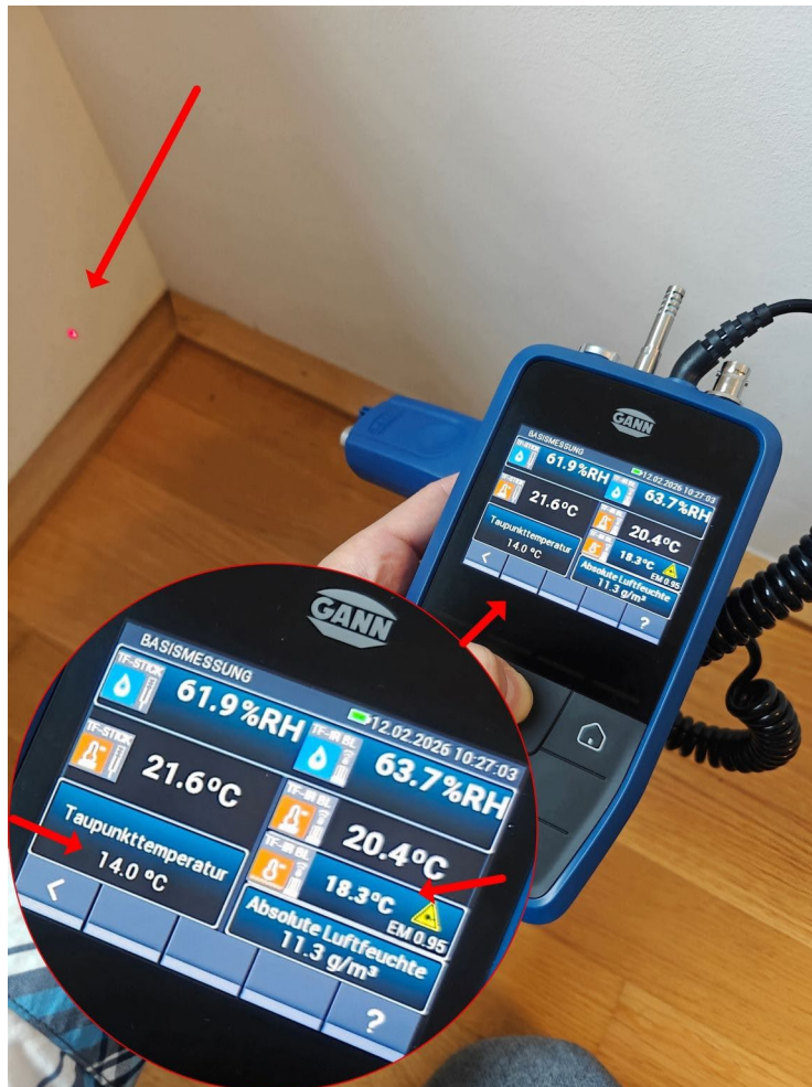
Bild 3 12.02.2026 Zimmer 1 - Kinderzimmer: Wandeck rechts unten; Messung der Oberflächentemperatur an Wand links. Diese beträgt an der mit Laser markierten Stelle zum Zeitpunkt des Ortstermins nur 18,3°C. Die ermittelte Taupunkttemperatur liegt hierbei im Verhältnis zu den gemessenen tatsächlichen Raumluftkonditionen bei relativ hohen 14,0°C.
