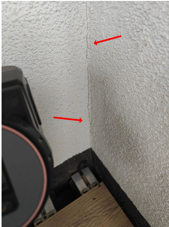
Bild 11 12.02.2026 Balkon: Rissbildung im Abrieb/ Putz der WDVS Fassade in der Wandchse zur Wohnung Top xxx. Aufgrund der vorangehenden Messungen deutet jedoch nichts darauf hin, dass es hierdurch einen Zusammenhang mit dem Auftreten des Schimmelbefalls gibt.
