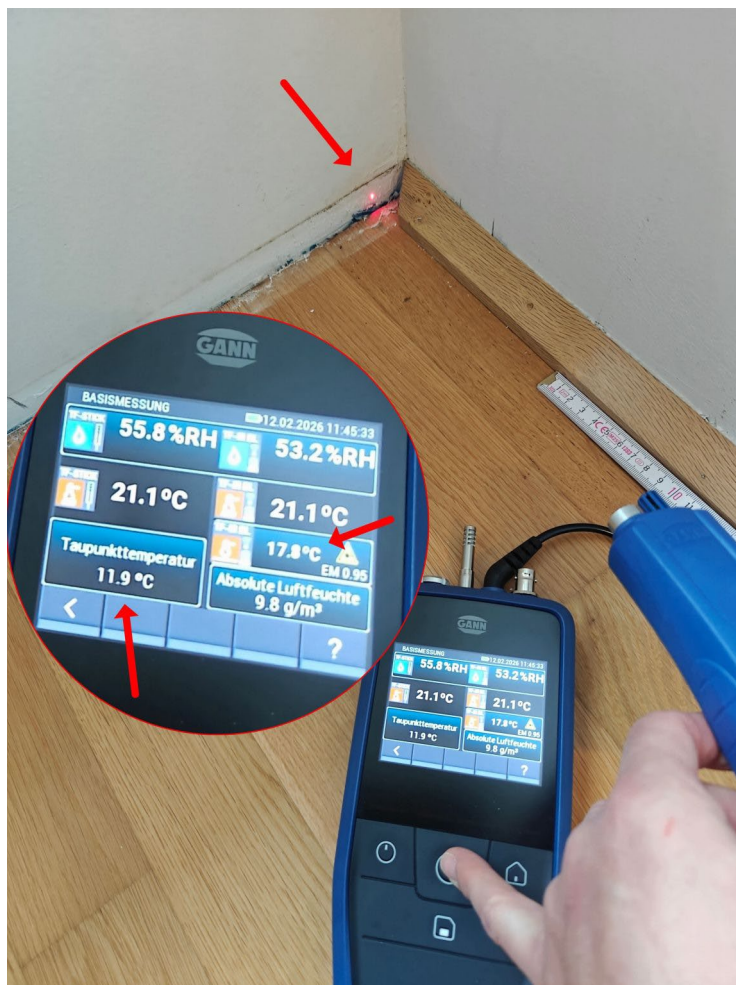
Bild 14 12.02.2026 Zimmer 1 - Kinderzimmer: Wandeck rechts unten; Messung der Oberflächentemperatur an Wand rechts nach kurzem Lüften der Wohnung. Diese beträgt an der mittels Laser markierten Stelle zum Zeitpunkt nur mehr 17,8°C. Die ermittelte Taupunkttemperatur liegt jedoch nun im Verhältnis zu den gemessenen Raumluftkonditionen bei nur mehr 11,9°C und damit im Normalbereich. Dies zeigt ebenfalls deutlich, dass bei gegebener Konstellation schon eine relativ geringe Veränderung der tatsächlichen relativen Luftfeuchtigkeit genügt, um eine signifikante Verschiebung der Taupunkttemperatur zu bewirken.
