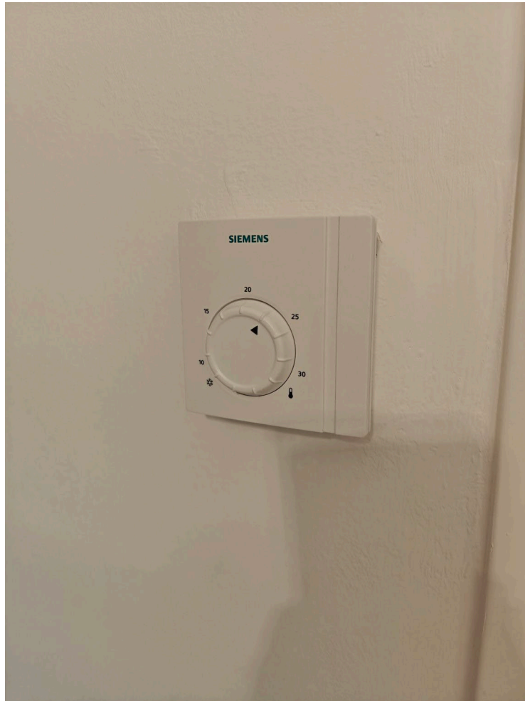
Bild 15 12.02.2026 Zimmer 1 - Kinderzimmer: Thermostat ist auf ca 22,5°C eingestellt, dennoch war der Fußboden in Zimmer 1 spürbar viel zu kühl. Dieses Empfinden wurde später auch mittels Wärmebildaufnahmen bestätigt.
