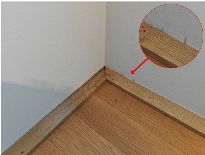
Bild 2 12.02.2026 Zimmer 1 - Kinderzimmer: Wandeck rechts unten, nach erfolgreicher Schimmelentfernung durch Firma xxxxxx. Gut zu erkennen sind die Spuren der durchgeführten Feuchtemessung seitens Firma xxxxxx.
