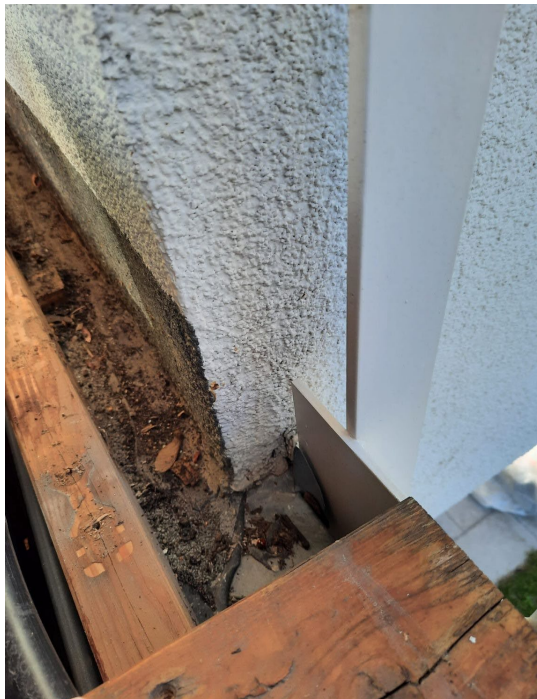
Bild 12 01.01.0001 Balkon: WDVS Fassade an der Wandaußenkante des Balkons ohne sichtbare Schäden und daher auch kein Hinweis auf allfällig vorhandene bauliche Wärmebrücken, welche die Schimmelbildung verursacht haben könnten
